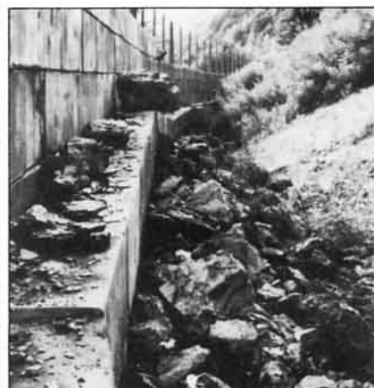
Eboulement des ruines de Séchilienne constaté à l'arrière de l'ouvrage de protection provisoire entre le 20 décembre 1986 et le 8 octobre 1987. L'état du remplissage de la fosse illustre la recrudescence des chutes de blocs accompagnée de franchissements de plus en plus fréquents.
