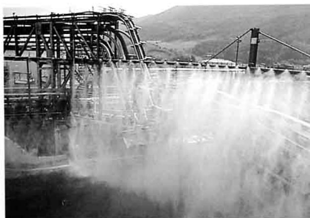
Rideau d'eau - Protection contre une fuite de chlore
