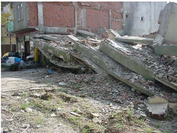
Structure poteau-poutre avec remplissage en maçonnerie. Cisaillement des poteaux et effondrement en mille-feuilles.
