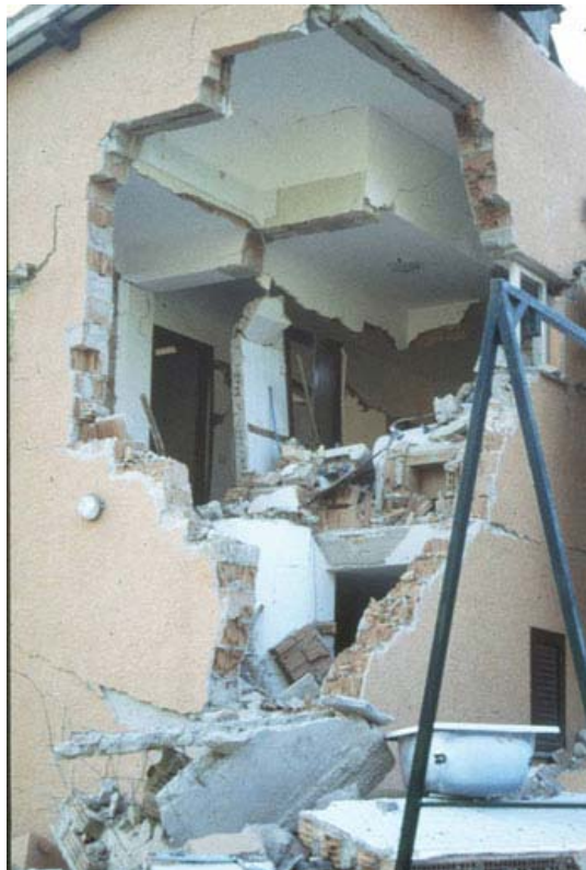
Photo 3 : angle vulnérable sans chaînage horizontal et vertical
