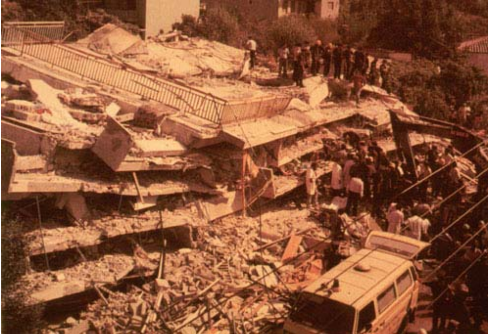
Photo 1 : Rupture fragile des poteaux
