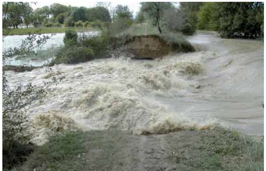
Brèche sur une digue de la Savoureuse. 500 bâtiments endommagés.
