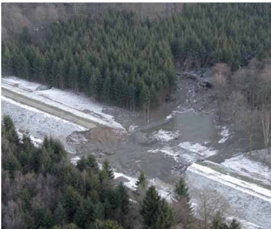
Brèche sur une digue de la Savoureuse. 500 bâtiments endommagés.
