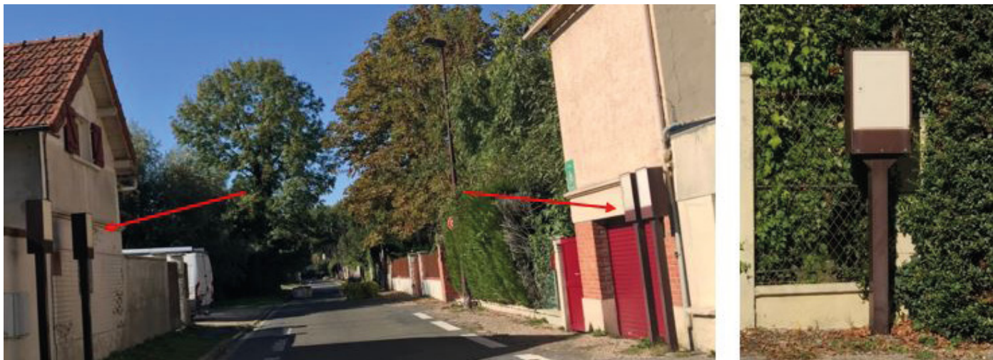
Photo 3: Armoires électriques surélevées à Jouy-le-Moutier (95) - © Varesano Lenzi, 2018.
