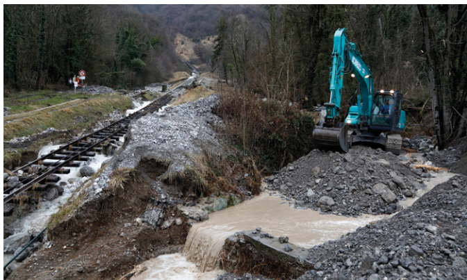
▲ Le lit du torrent, ainsi que les différents ouvrages de franchissement ont été intégralement comblés par les sédiments charriés au cours de la crue, conduisant à de multiples débordements et des divagations sur le cône de déjection.
