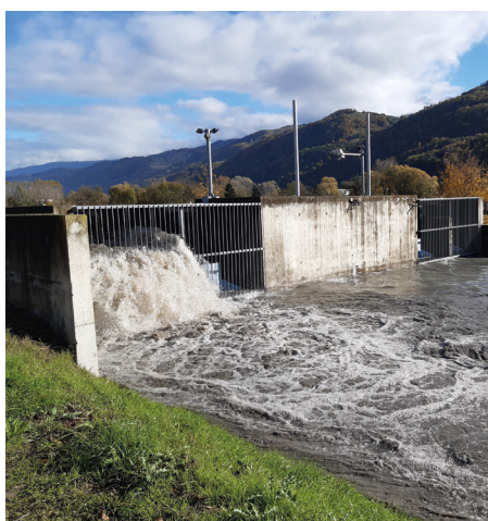
Photo 2 : la station de pompage de Cheminade à Gières - © Syndicat mixte des bassins hydrauliques de l'Isère.
