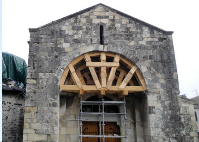
Étaïement des voûtes et bâchage de la chapelle octogonale © Photo Marc Givry, architecte
